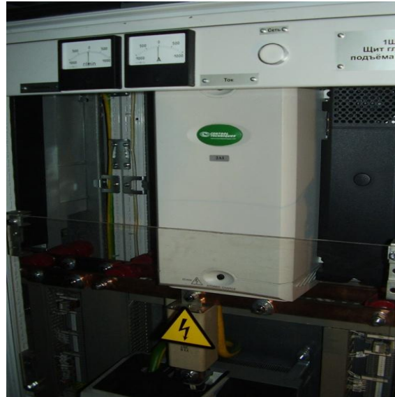
Щит главного подъема
