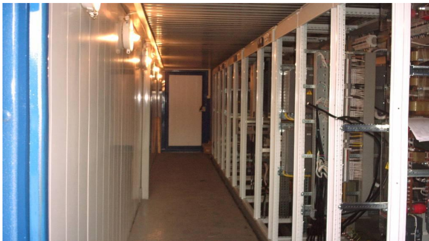
Оборудование в контейнере
