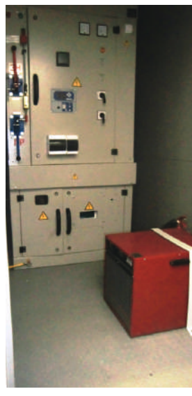
Высоковольтная вводная ячейка
