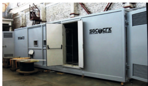
КТП 1500кВт и ЗРУ 6кВ для ООО «СГК-Бурение»
