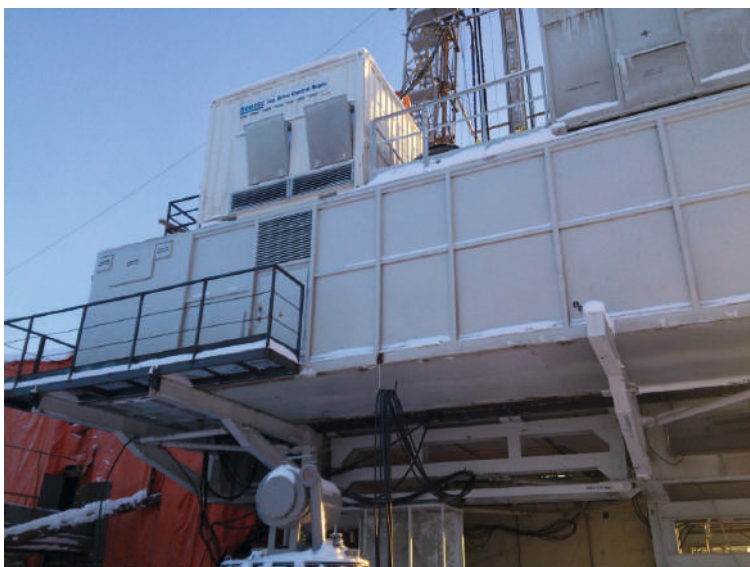
Контейнер КТУ с блоком тормозных резисторов
