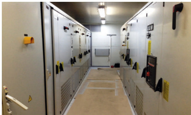
Контейнер КТУ внутри
