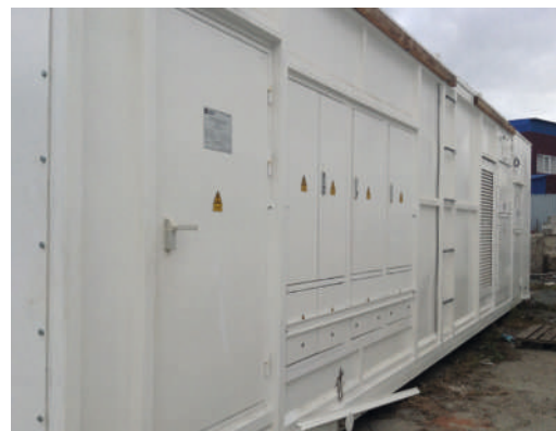
Внешний вид контейнера ВЛБ
