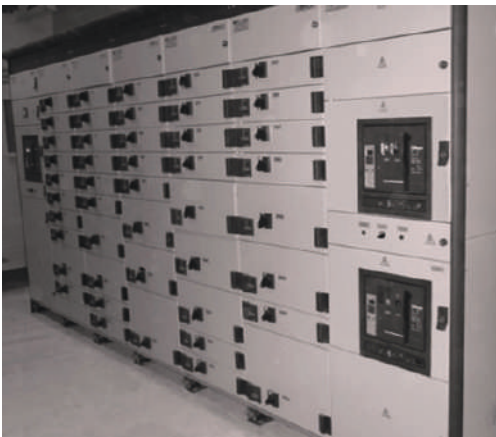
Щит РУСН 0.4 кВ для ЧТЭЦ-3
