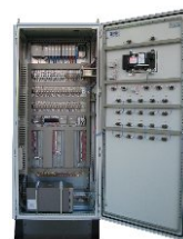
Шкаф управления вспомогательными механизмами насосного блока (ШНБ)
